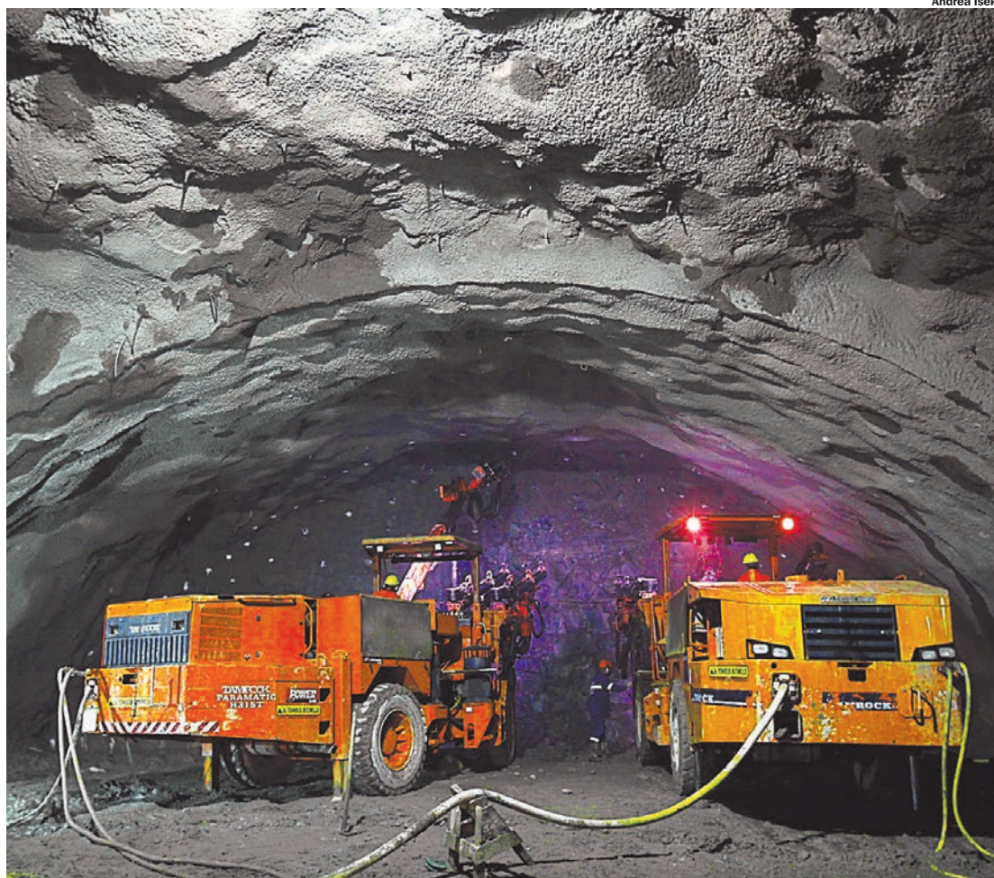
Trecho entre Mauá e Ribeirão Pires está sendo construído; demora nas licenças pode deixar máquinas paradas
