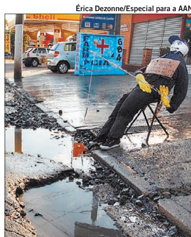
João Buracão "pesca" em cratera na Avenida Mirandópolis: transtornos
