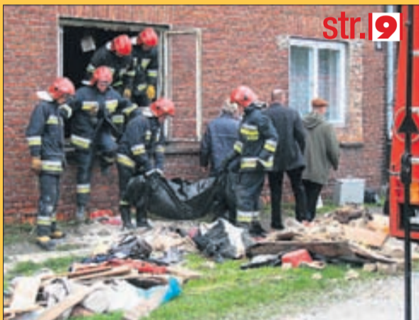
Do katastrofy doszło na ul. Tkackiej 41. W parterowym budynku, w którym zawalił się dach pod gruzami zginęła 53-letnia kobieta.
